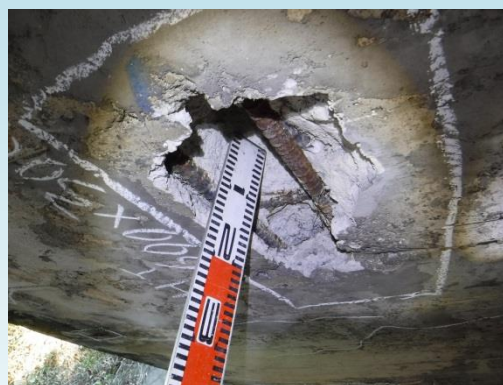
発見された変状
