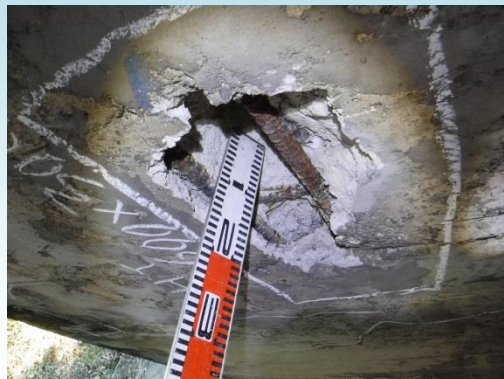
発見された変状
