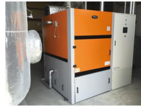
宿泊施設への 木質ボイラによる熱供給
