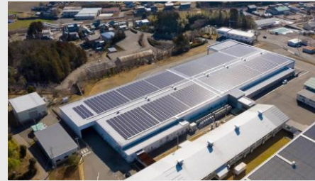
太陽光発電設備(福井鋳螺株式会社)
