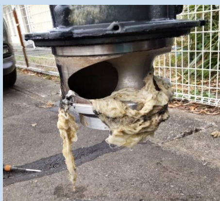
ポンプ内で絡みつく繊維類
