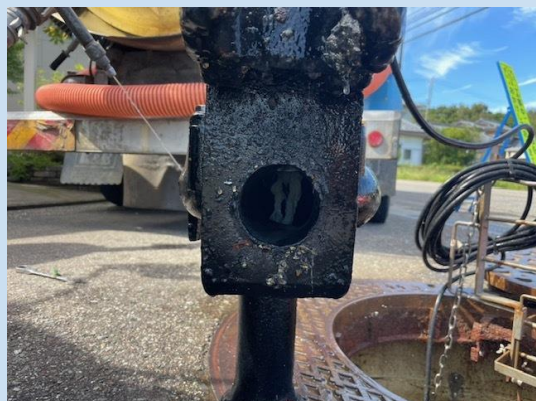
ポンプ内で絡みつく繊維類
