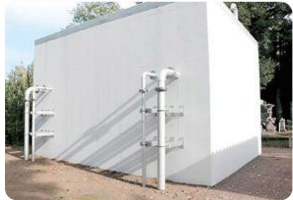
更新された吉崎配水場
