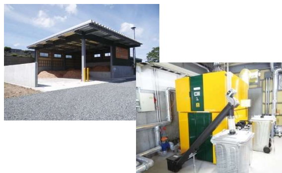
木質バイオマスの熱利用とボイラー
