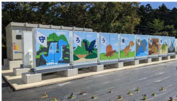
AIを使った大型の蓄電池システム（913kWh）
