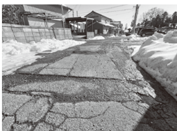
傷んでいる市道
