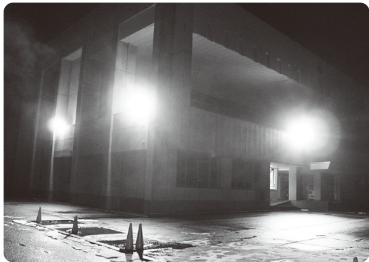
農業者トレーニングセンターのLED照明
