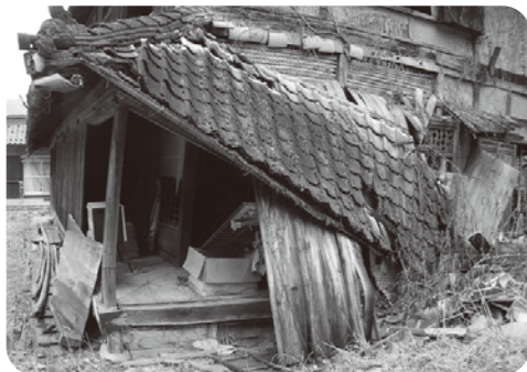
危険な空き家の例
