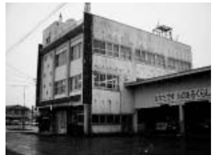
老朽化が著しい金津消防署
